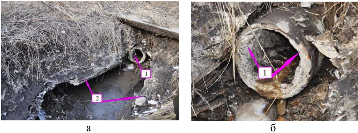
Рис. 4.13. Образования кальцита на участке выпуска техногенного фильтрата в р. Черемушка из трубопровода дренажной системы золоотвала Красноярской ТЭЦ-3.
